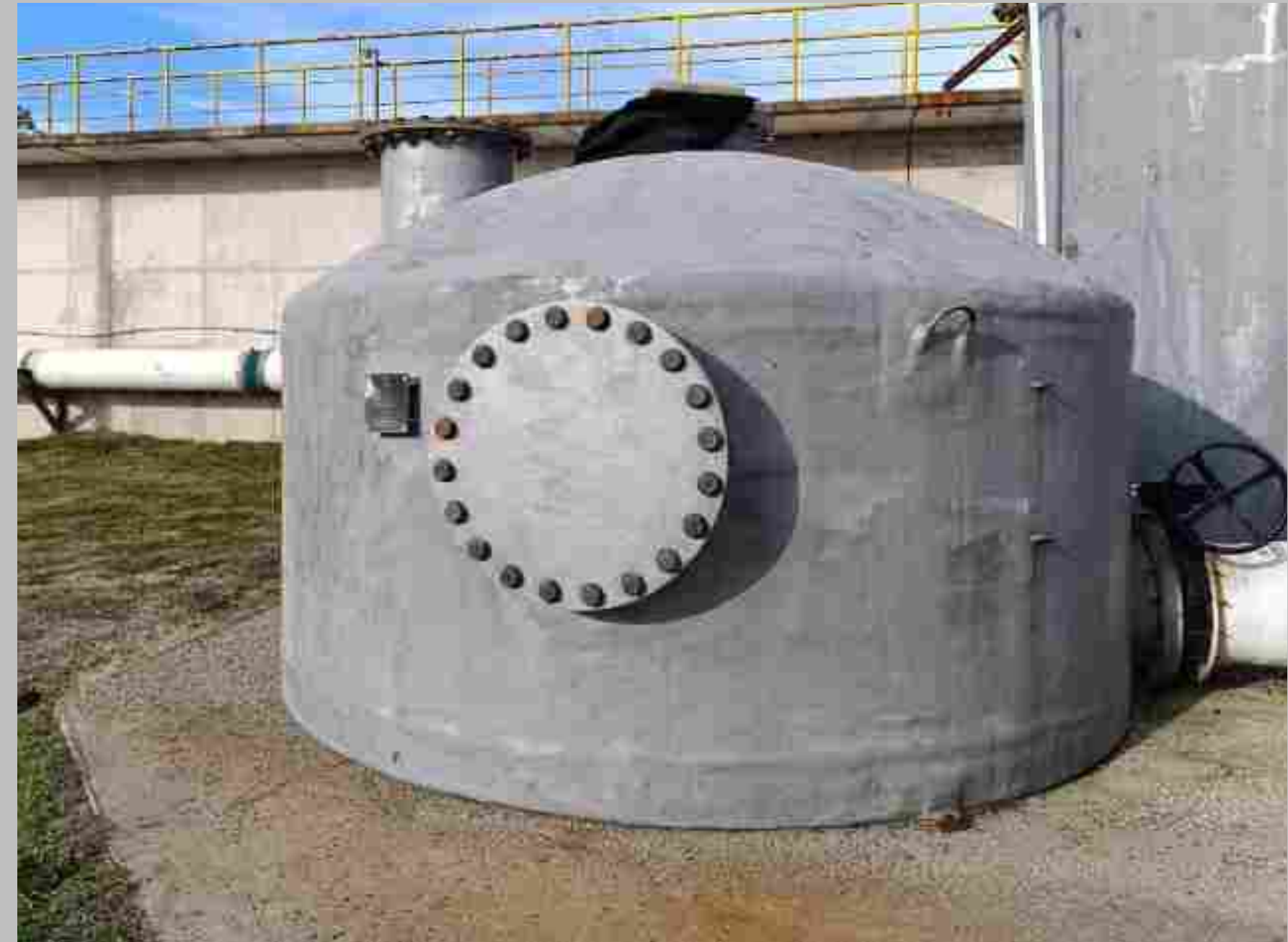
Filtro GAC Este
