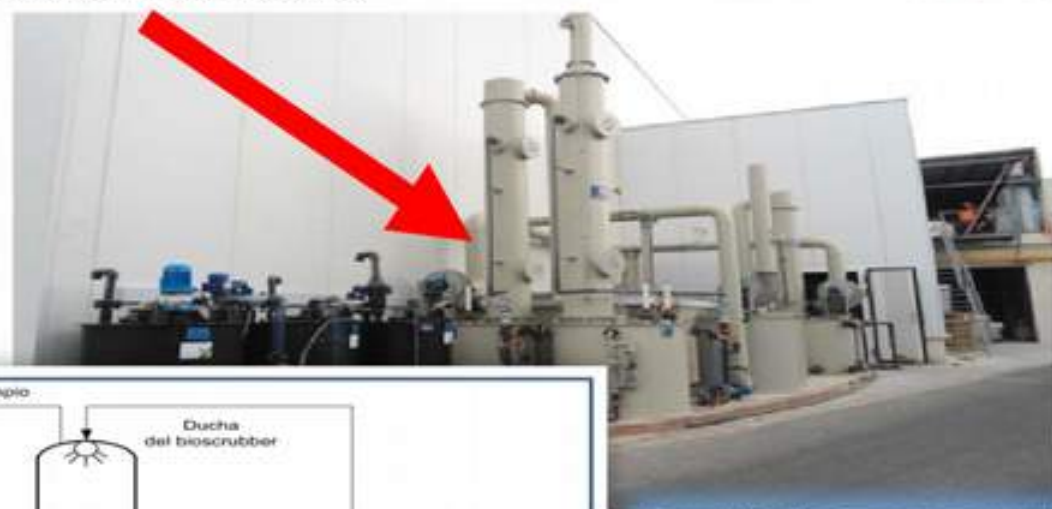
Primera torre de lavado
